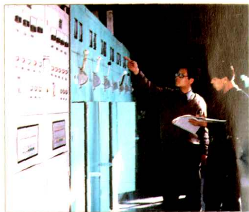
总电仪车间配电室
