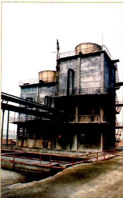
氨氮废水闭路循环系统
