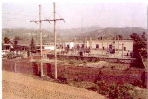
◀西村35千伏变电站
