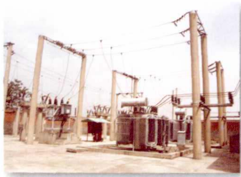
▲高村35千伏变电站
