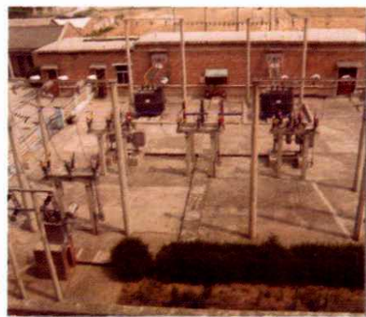
▲ 葛庄35千伏变电站
