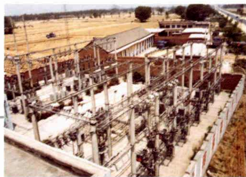
▲ 板桥35千伏变电站
