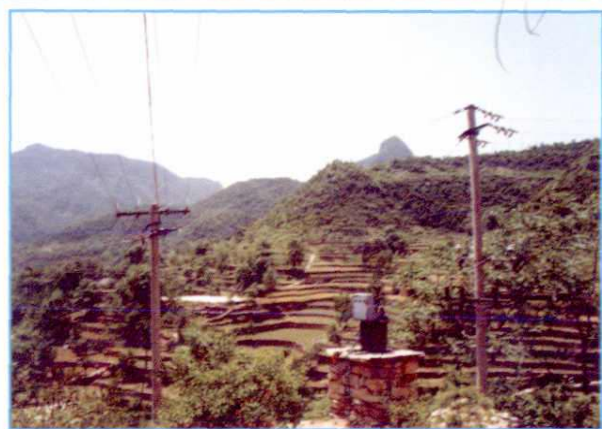
▲横跨豫、晋交界的配电台区
