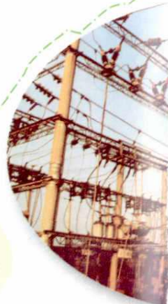
▶被市局授予“样板变电站”的梁庄110千伏变电站
