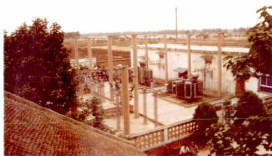
◀王屯35千伏变电站
