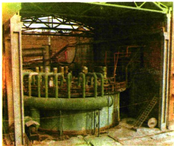
◀ 公司为云南磷肥厂安装的年产十万吨重钙的关键设备——萃取槽。
