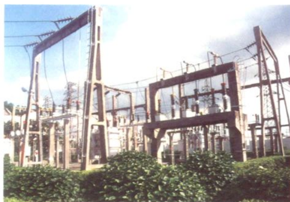
110千伏输变电站
