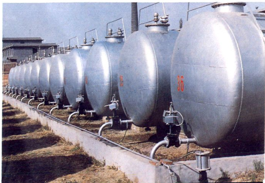
凤翔县石油公司油库气动阀门装置
