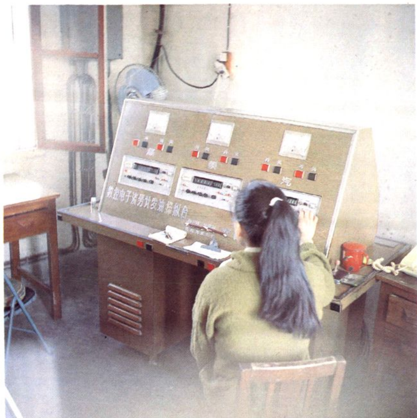
汉 中 石 油 分 公 司 油 库 数 控 电 子 流 量 计 发 油 装 置
