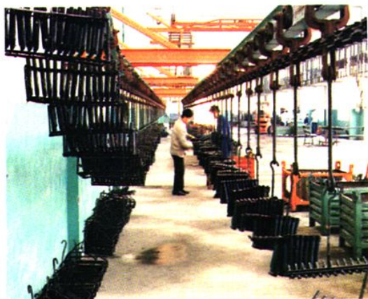
制泵厂新建油漆线
