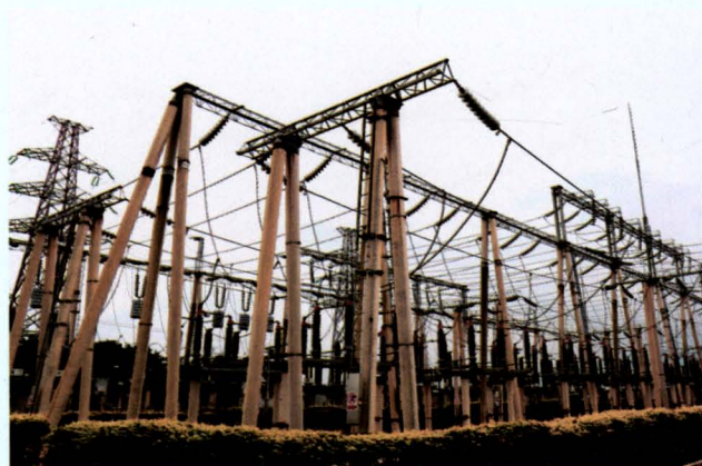
110千伏南恩变电站，变电容量81500千伏安
