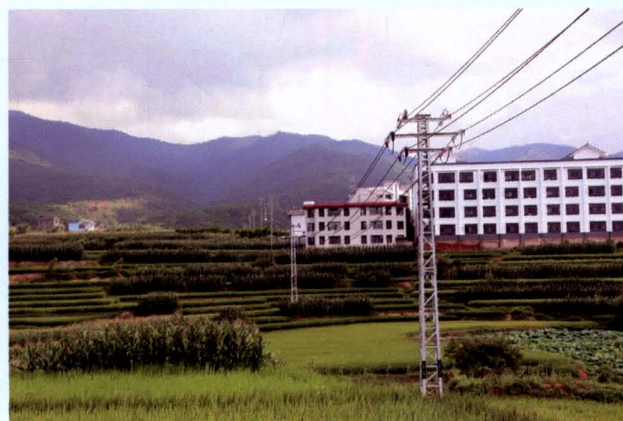
改造后的10千伏农村线路
