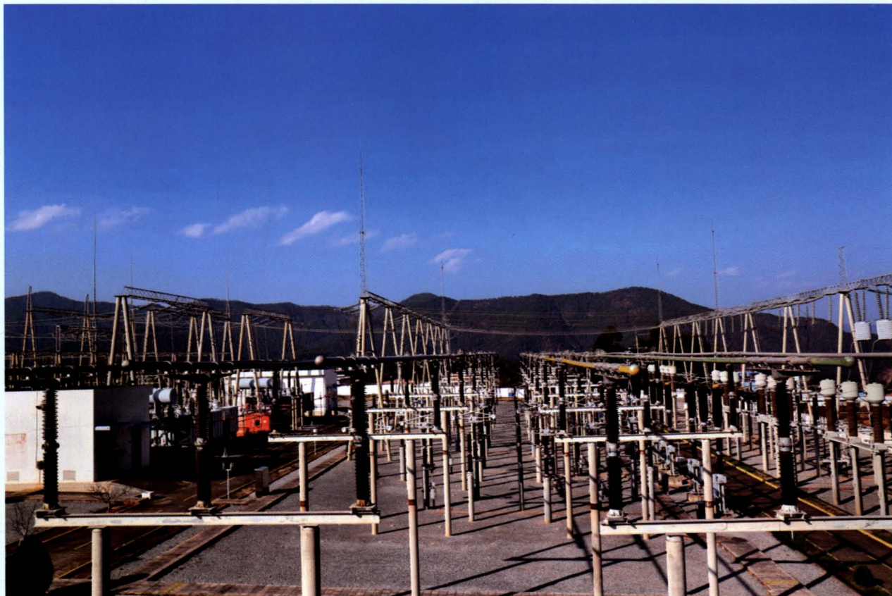
220千伏新平变电站，变电容量360000千伏安
