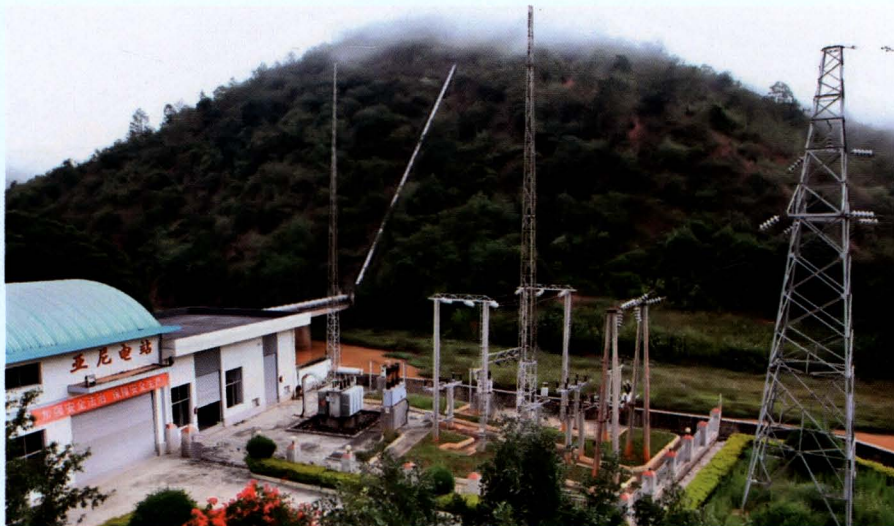
位于平甸河水库下游的 亚尼电站，总装机 2 \times 2000 千瓦
