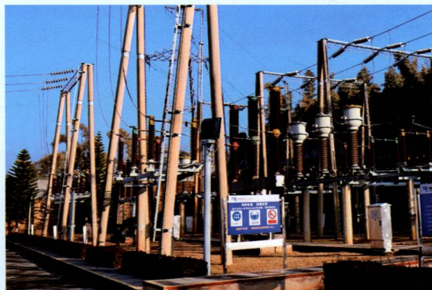
110千伏桂山变电站，变电容量36000千伏安
