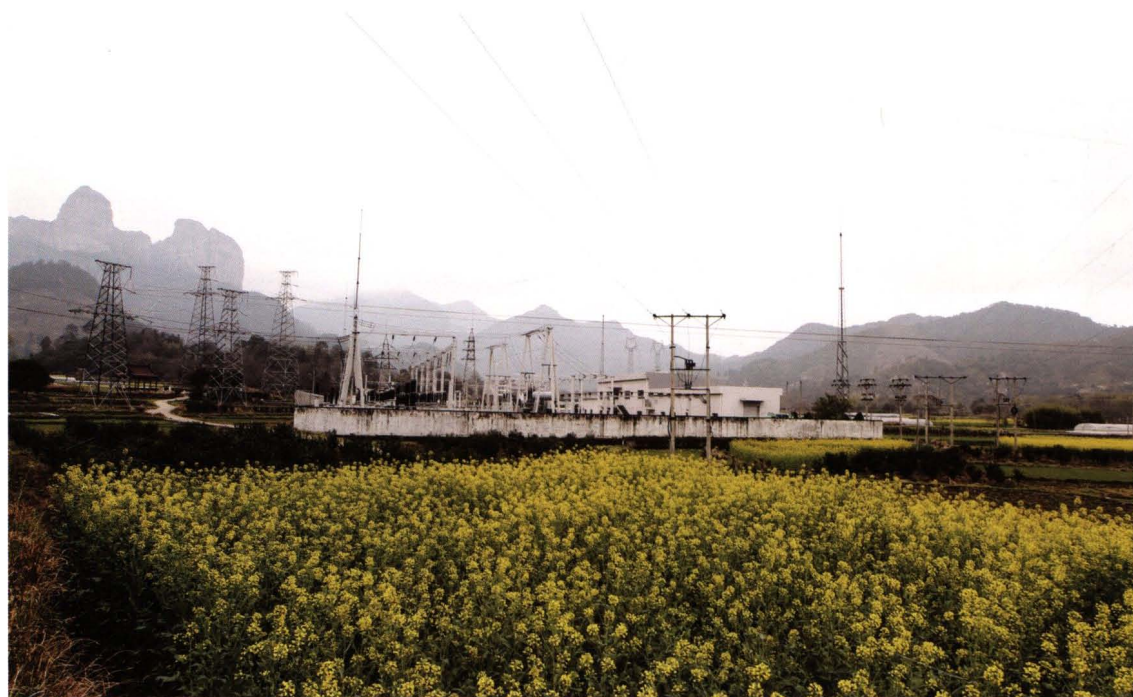
2000年12月投运的110千伏岩头变电站
