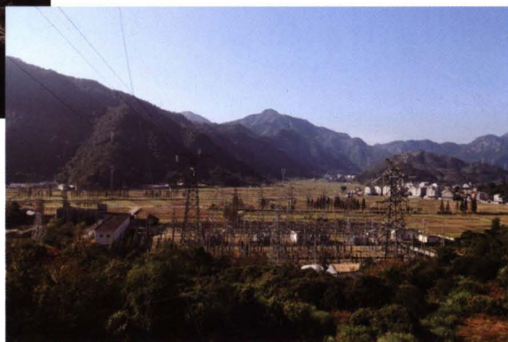
运行中的220千伏楠江变电站
