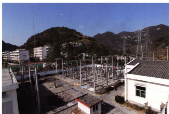
2001年10月投运的35千伏鹤盛变电所
