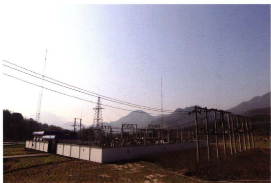
1998年8月投运的35千伏岩坦变电所
