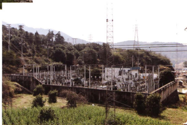
1996年11月投运的35千伏沙头变电所
