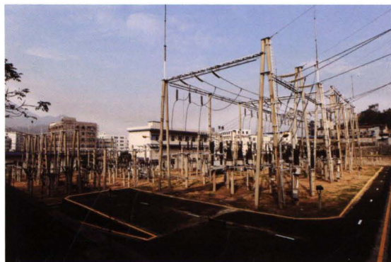
运行中的110千伏菇溪变电站
