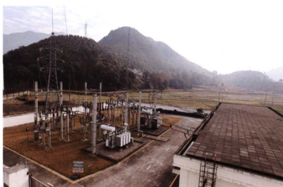
2006年7月投运的35千伏徐岙变电所
