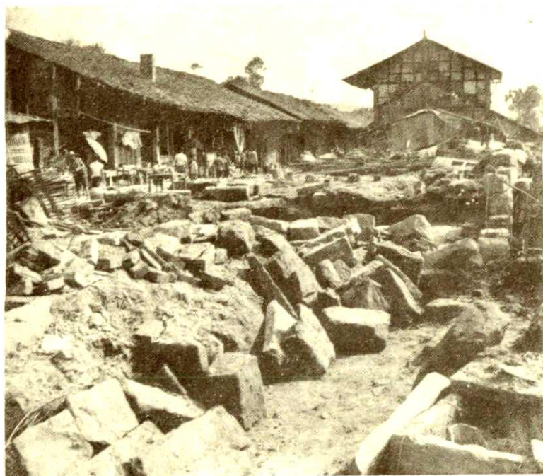
富溪公社场镇居民房屋被洪水冲毁情况
