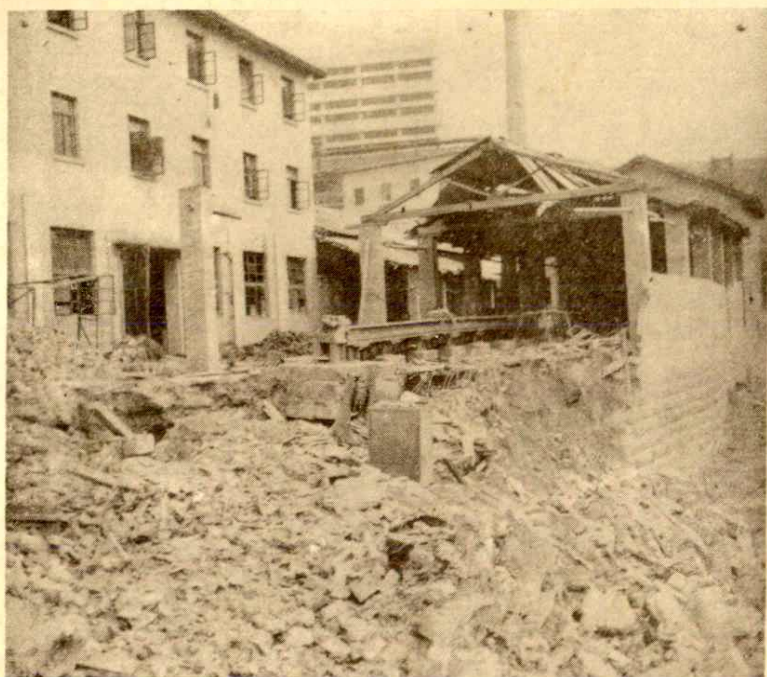
县机械厂一车间被洪水冲垮情况 (李吉德摄)
