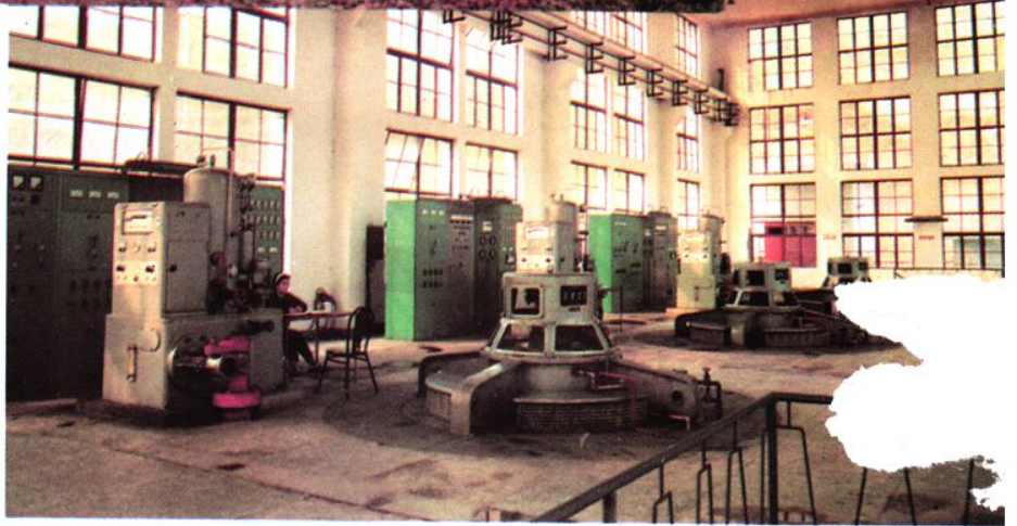
机组 虎跳河电站发电
