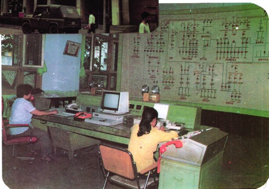
▲ 县电力公司调度室
