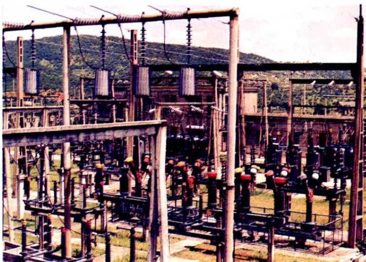
零陵地區最早建成的 零陵楊梓塘 110 千伏 變電站，1963年動工， 1966年投運
