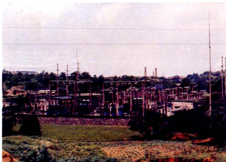
1966年建成的祁陽 寶塔山 110 千伏變電站
