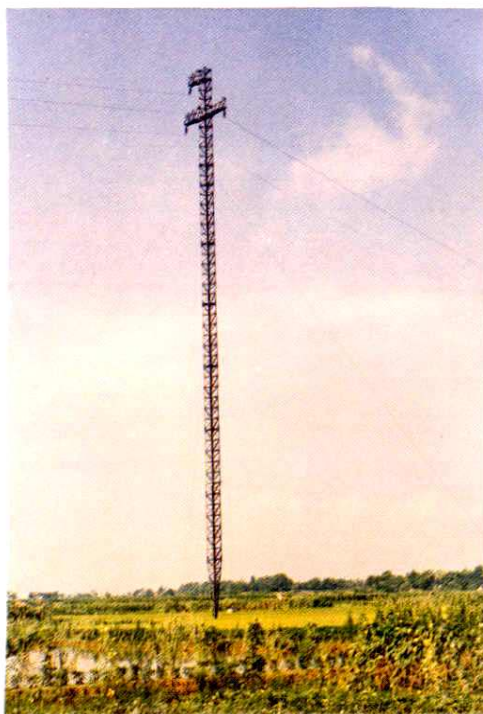
► 跨越湘江的曲河十千伏錐型鐵塔， 一九六四年建。
