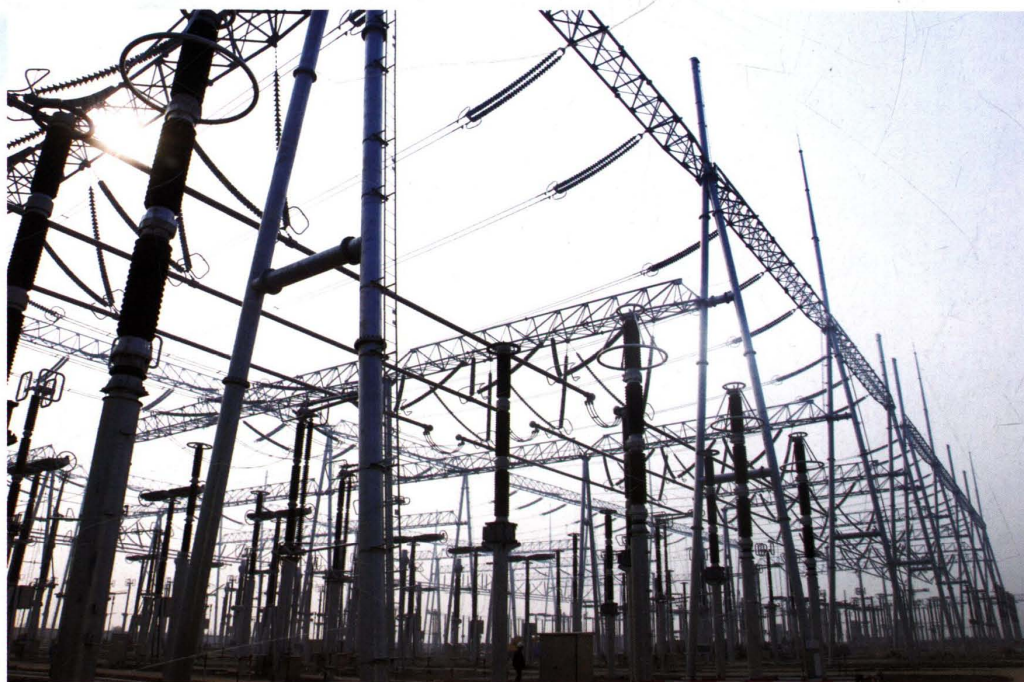
全国首座“镜像”布置 500 千伏变电站——500 千伏常熟南变电站
