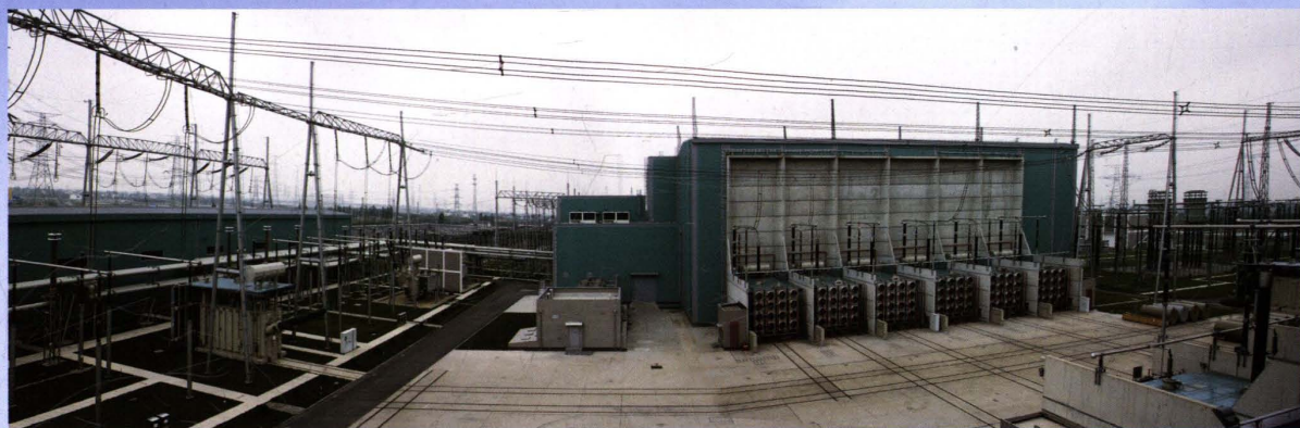
锦屏—苏南±800 千伏特高压直流工程苏州（同里）换流站
