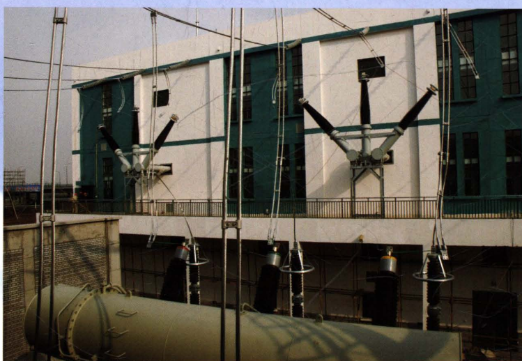
全国首座智能变电站——220 千伏西泾变电站
