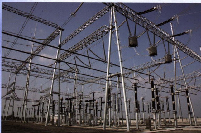
500 千伏泰北变电站
