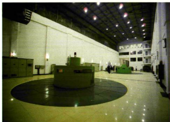
洞坪水库电站地下厂房
