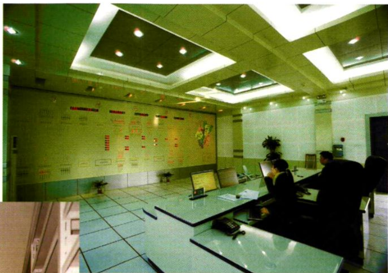
县电力公司调度室
