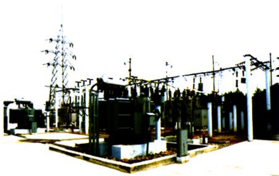
金龙山变电站
