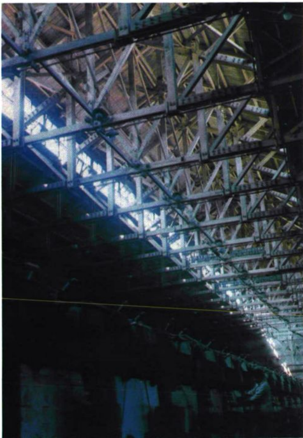
沈阳化工厂金属阳极 电解烧碱装置
