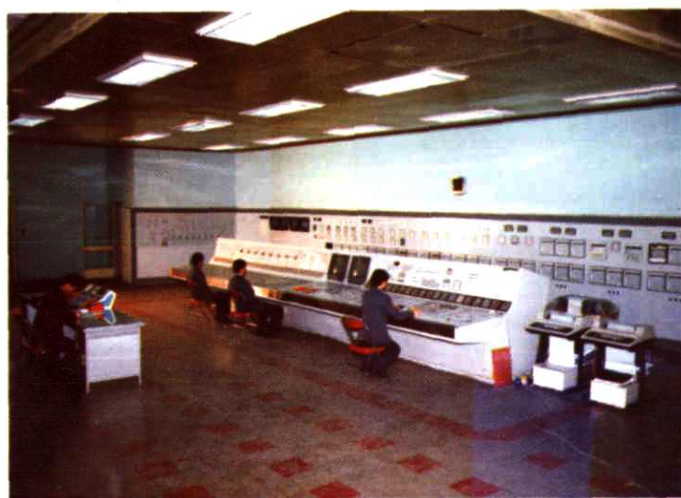
30万机组控制室
