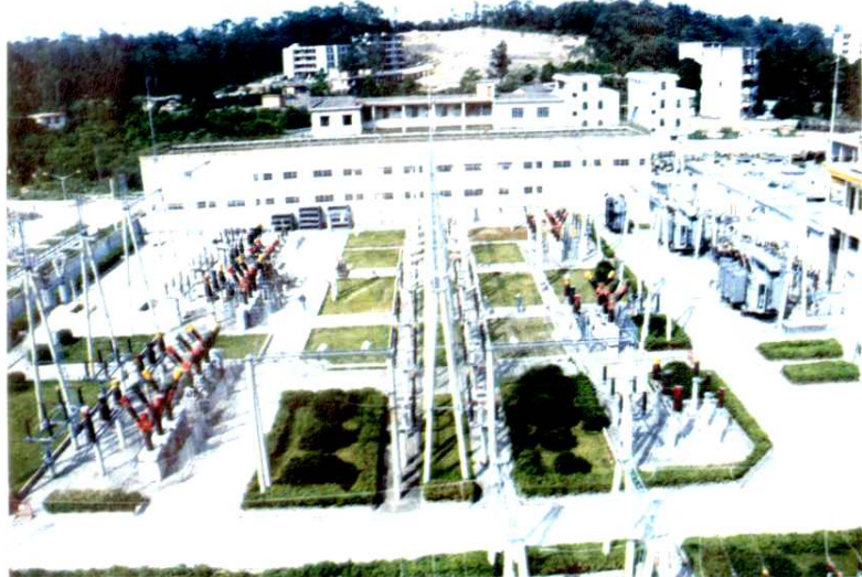
1986年12月投产的 110千伏新华变电站户 外高压设备
