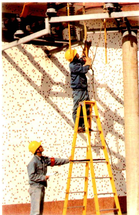
变电值班人员进行设备停电验电接地
