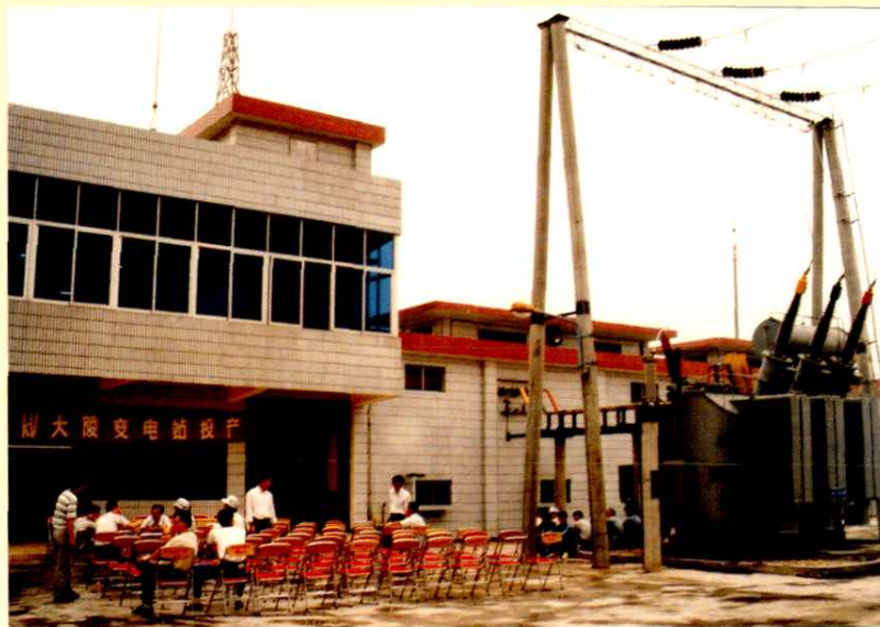
1998年5月，110千伏 大陵变电站建成投产
