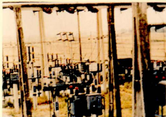
1964年投产的35千伏 清潭变电站设备
