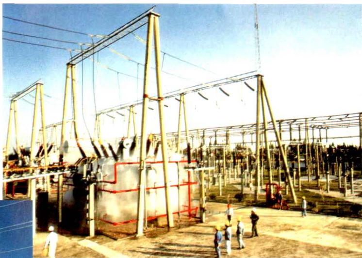
2000年花都局220千伏田心变电 站进行主变水喷雾灭火装置试验
