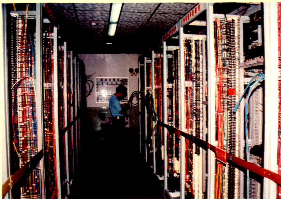
变电继电保护专业员工在110千伏新华变电站检查保护装置（1997年）
