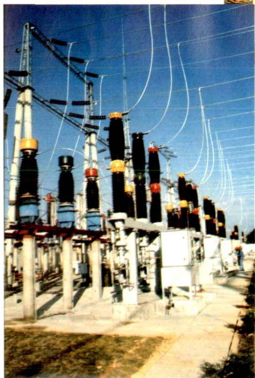
1997年1月投产的花都局 第一座220千伏田心变 110千伏设备
