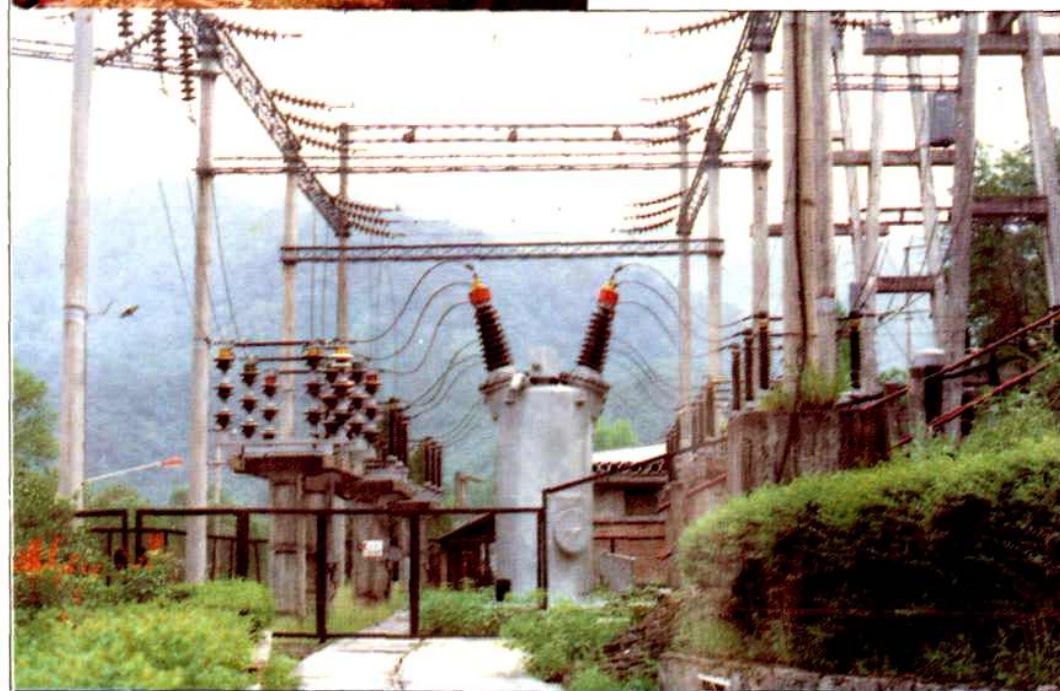
磨子潭 110 千伏开关站
