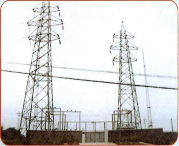
位于西山社区的 11 万伏无人值守变电站
