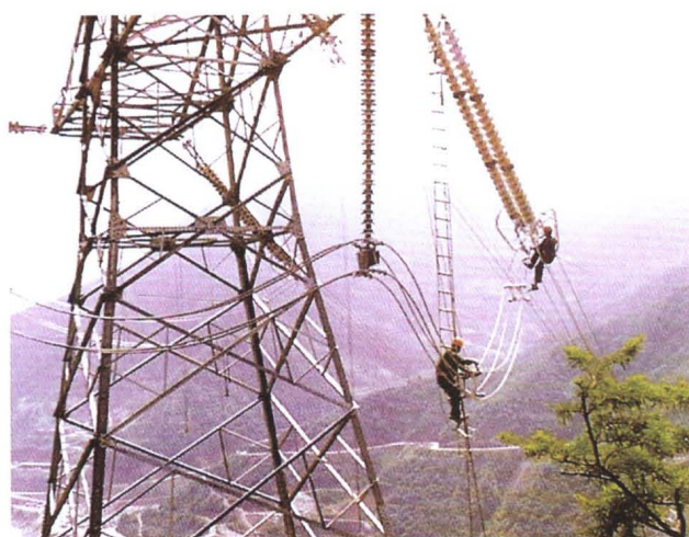
1997年建成的500千伏二滩—自贡送电线路
