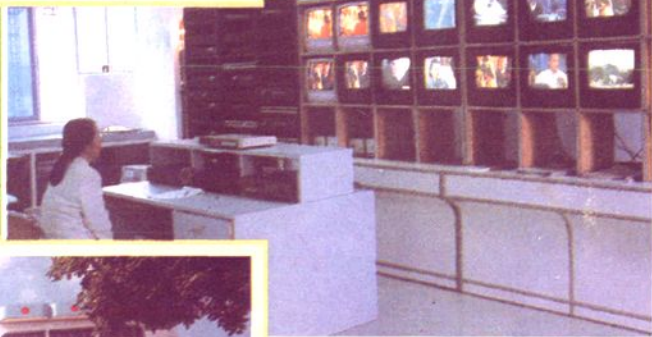
——县有线电视台机房
