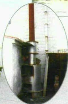
醫療垃圾焚燒爐
