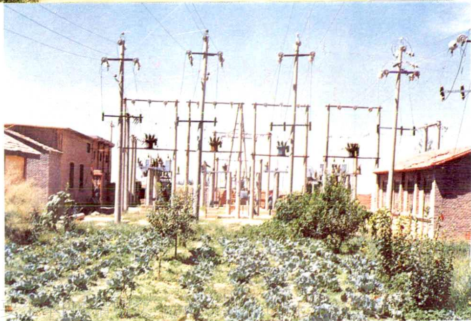
▶ 永丰滩变电站一角
