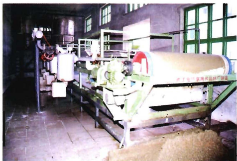
▲1999年，金泰公司 安装了带式水平真空过 滤机，彻底治理了硝酸钙 泥浆污染
