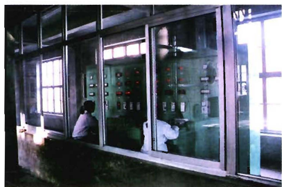
金泰公司 10 吨沸腾炉控制室
