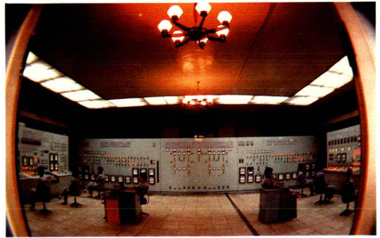
17 陡河电厂主控室
