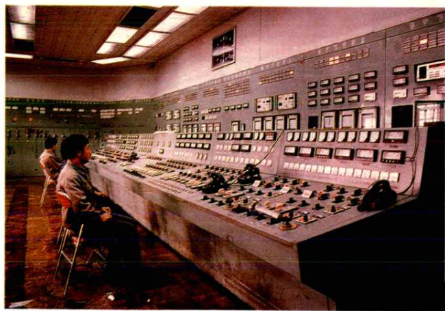
21 清河电厂集控室
