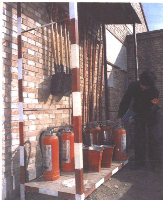
◀ 消防设施、器具及制度健全。
