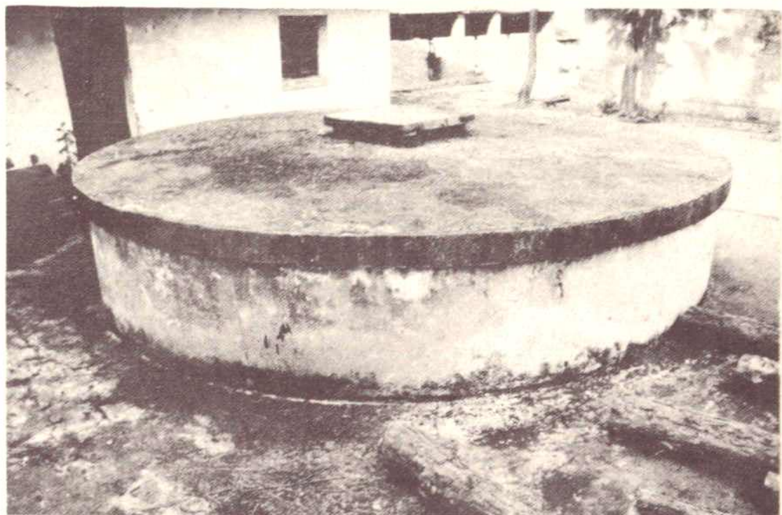
水泥圓型半地下油池
