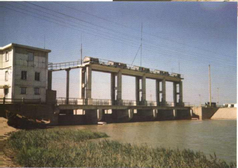
青静黄排水渠挡潮闸
