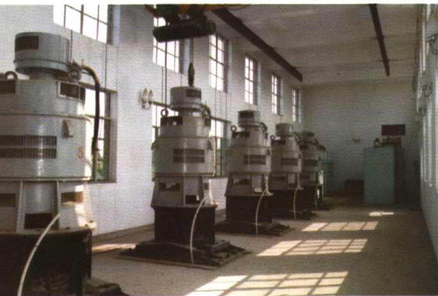
西部扬水站机房内景
