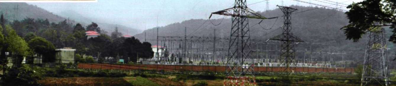
1970年7月，钟祥220千伏胡集变电所建成投运
