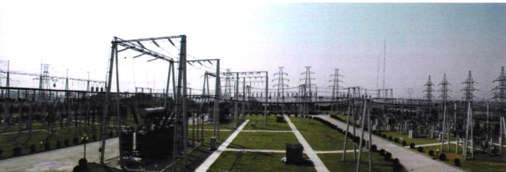
2000年1月，荆门220千伏枣山变电所建成投运
