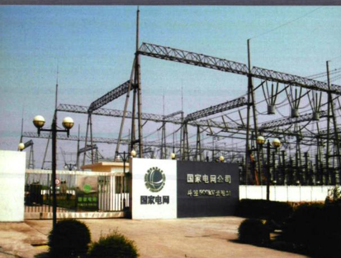
2002年4月，荆门500千伏斗笠变电站建成投运
