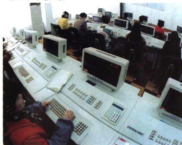
程控电话控制室
