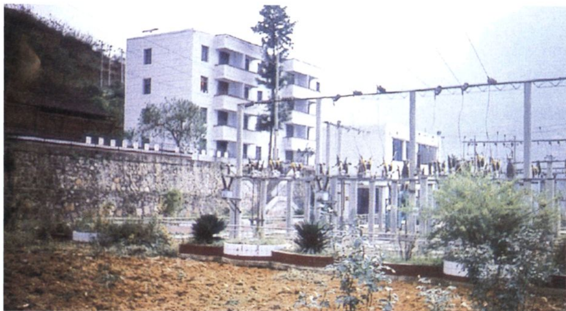
董家坡（迎政乡）变电站
