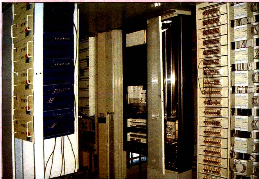
▲ 现代化的程控电话机房。
