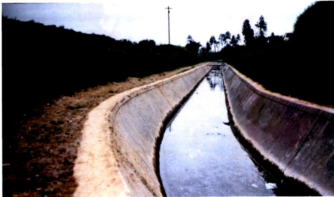
1993年整治衬砌后的双河分支渠
