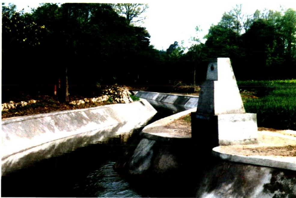
试点工程完成的五星分干渠上段泄水闸门
