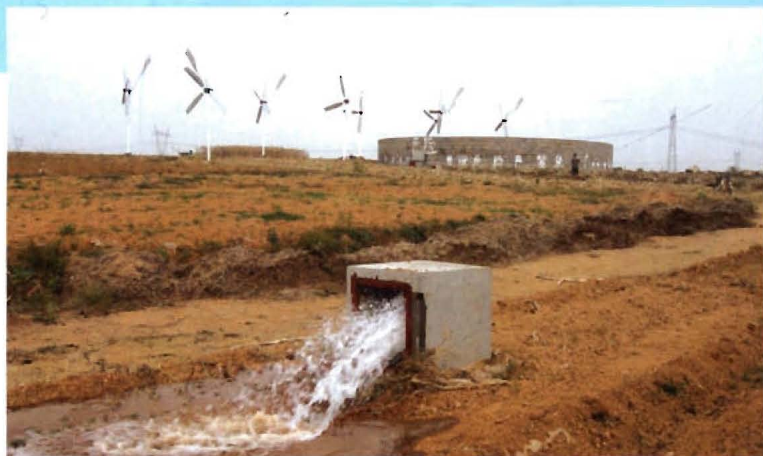
寨里河乡土地 整理项目区的风力 提水灌溉设施
