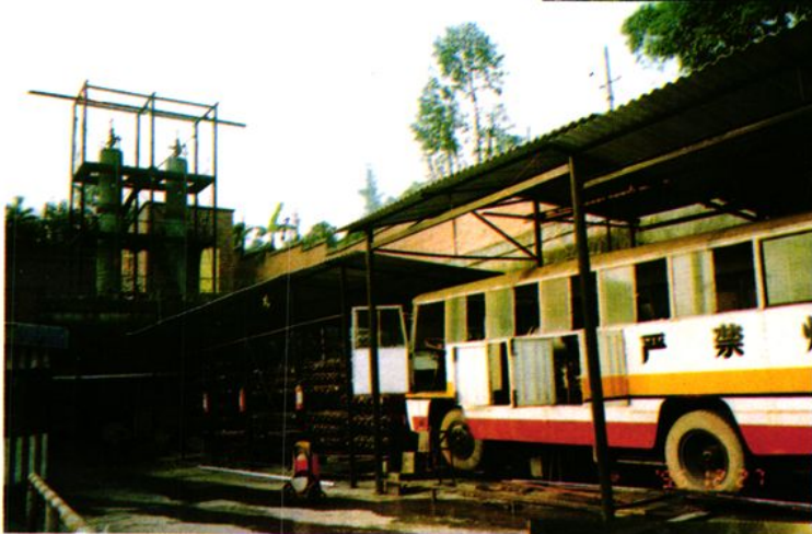
自贡市公交总公司压缩 天然气加气站
