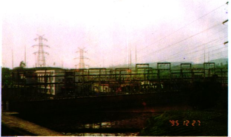
舒平 220KV 输变电站
