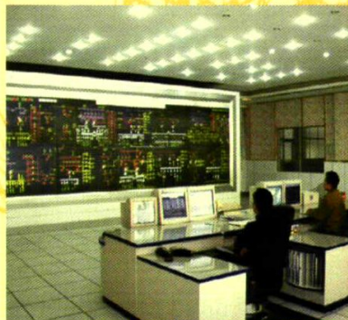
黄冈供电局调度指挥台
