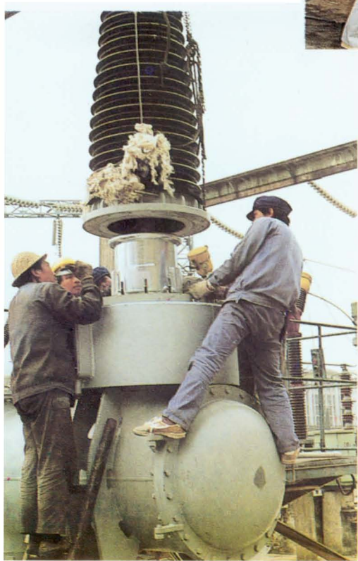
◁ 1993年将部分220千伏线路开关更换为先进的六氟化硫开关(秦昌展摄)
