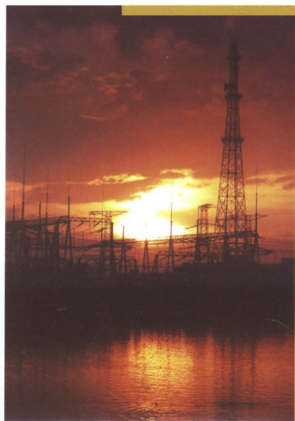
“西电东送”的重要枢纽——广西柳州沙塘 500 千伏变电站。黄启辉/摄
