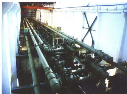
国内海拔最高的500千伏普提开关站内安装的目前国内规模最大的氟氧化硫全封闭组合电器(GIS)
