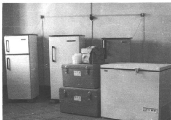
县卫生防疫站冷链设备
