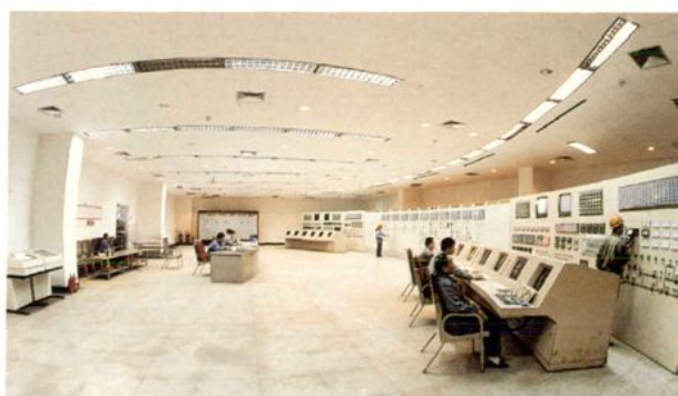
新厂主控制室
