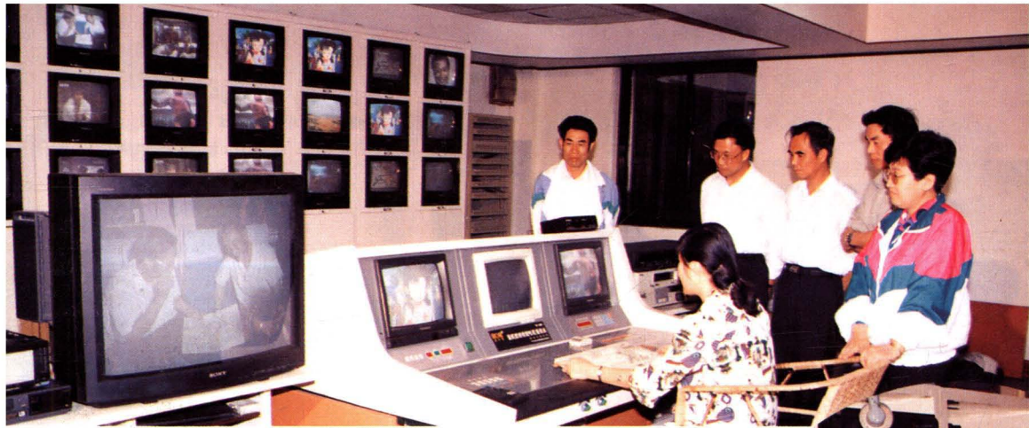
◀ 南宁有线电视台前端机房
