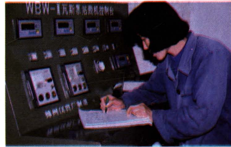
瓦斯泵站微机控制台
