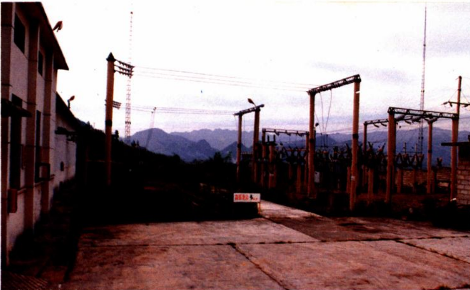
德江县城变电所
