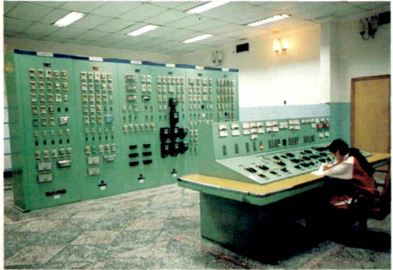
坛罐窑电站中控室
