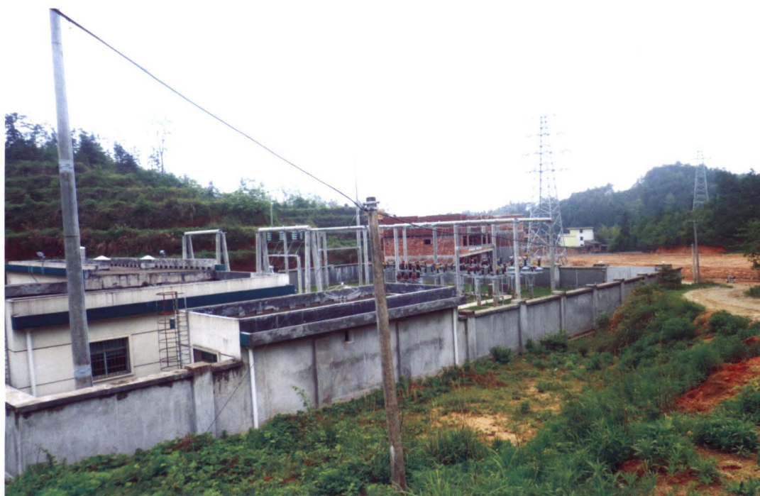
境内国家电网变电站
