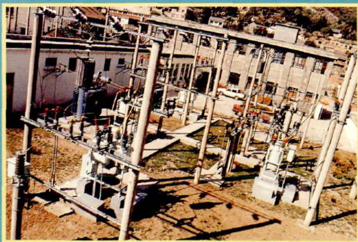
城关 35 千伏变电站设备区
