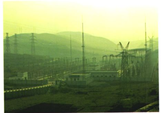
五里牌220变电站
