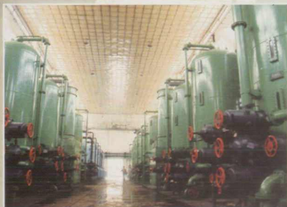
化学水处理室
