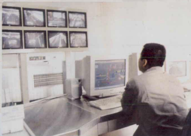
输煤电视监控系统
