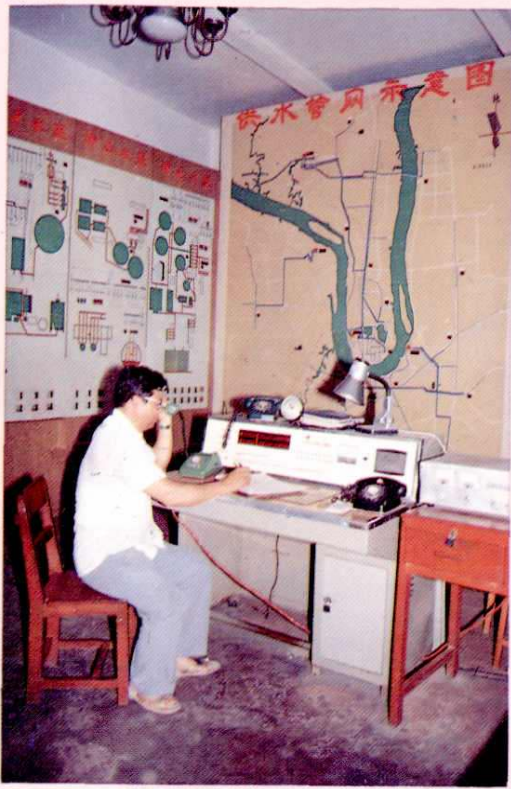
公司中心调度室
