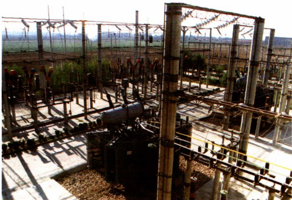
东区王村变电站
